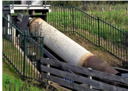
Foto 9 Visvriendelijk vijzelgemaal Koopmanspolder
